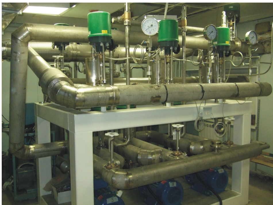
Рис. 10. Насосно-распределительная станция криосистемы ГВУ-600
