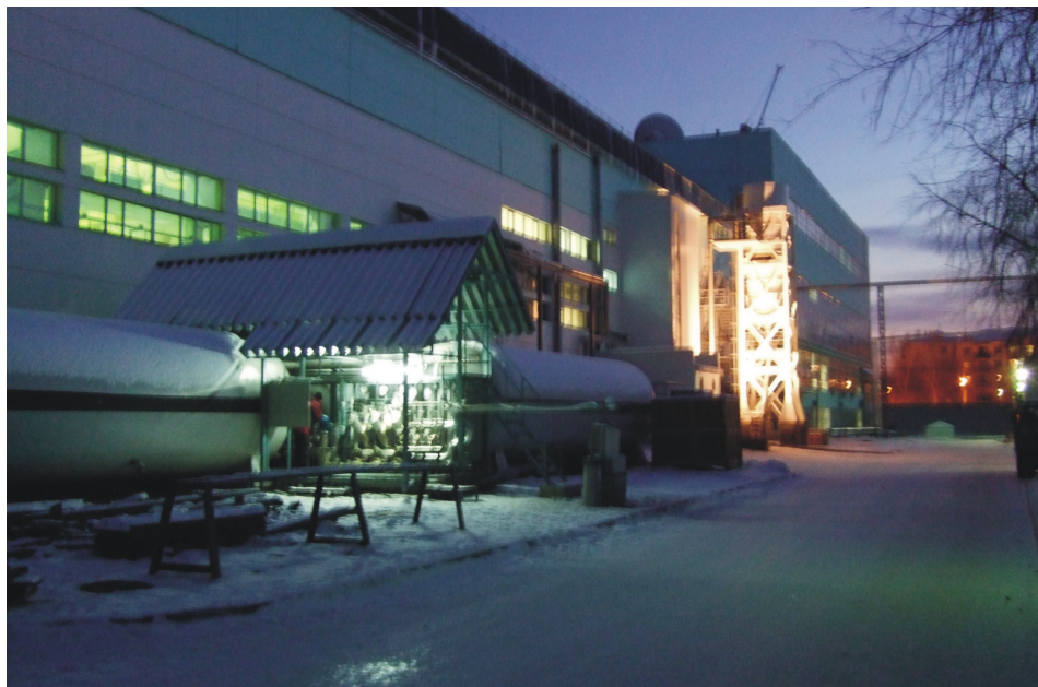
Рис. 9. Наружные конструкции криогенной системы стенда ТВИ ГВУ-600
