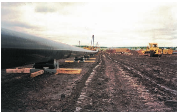
Рис. 3. Трубопровод на роликовых опорах
